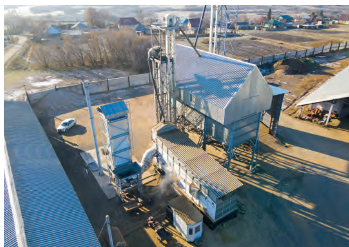
Новый теплогенератор в ООО «Лебеди», Кузбасс
